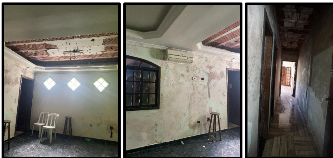
Figuras 4, 5 e 6 - Locais interditados pela Vigilância Sanitária.
