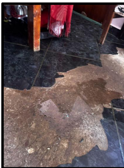
Figura 10 - infiltração e acúmulo de água nos banheiros.
